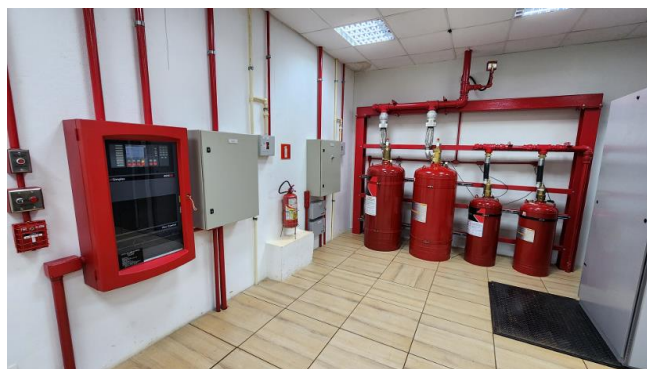
Figura 5 – Sistema de SPCI em Datacenter
