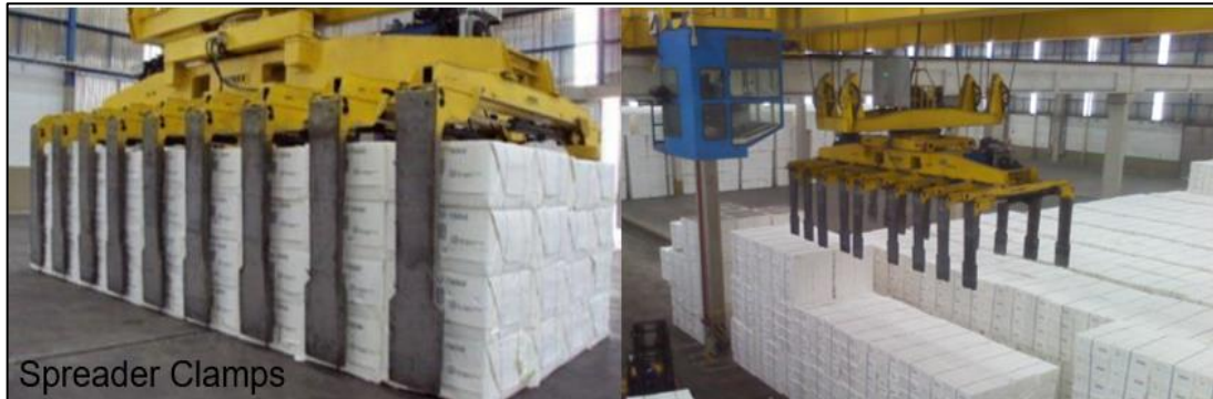
Figura 6 – Ponte rolante com spreader clamps para celulose
